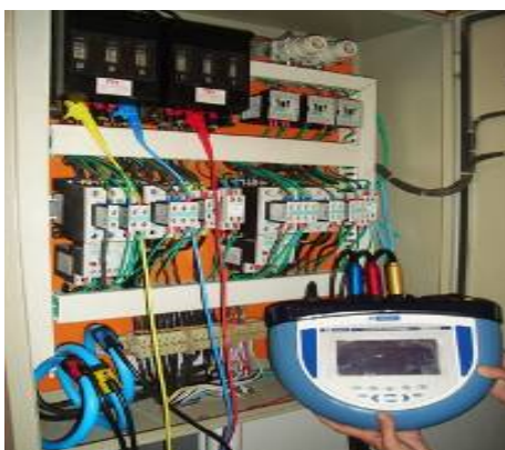
Figura 10: Analisador de energia utilizado no monitoramento.
