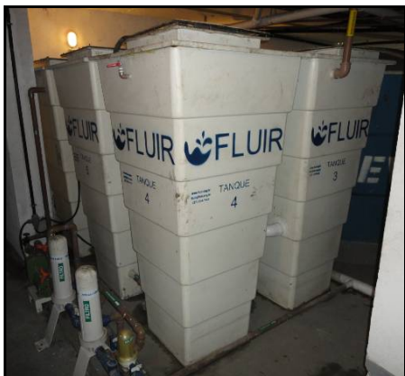
Figura 8: ETAC localizada no subsolo.
