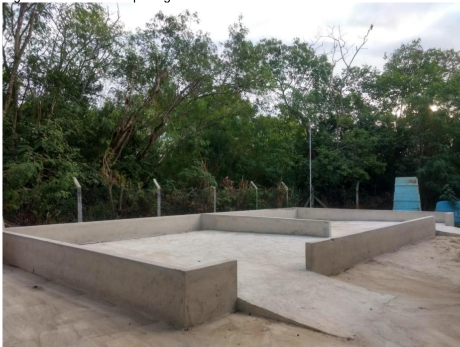
Figura 7 - Pátio de compostagem construído
