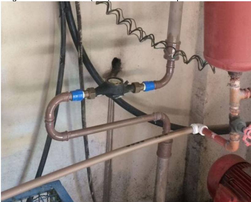
Figura 15 - Hidrômetro (H17) – Reservatório superior
