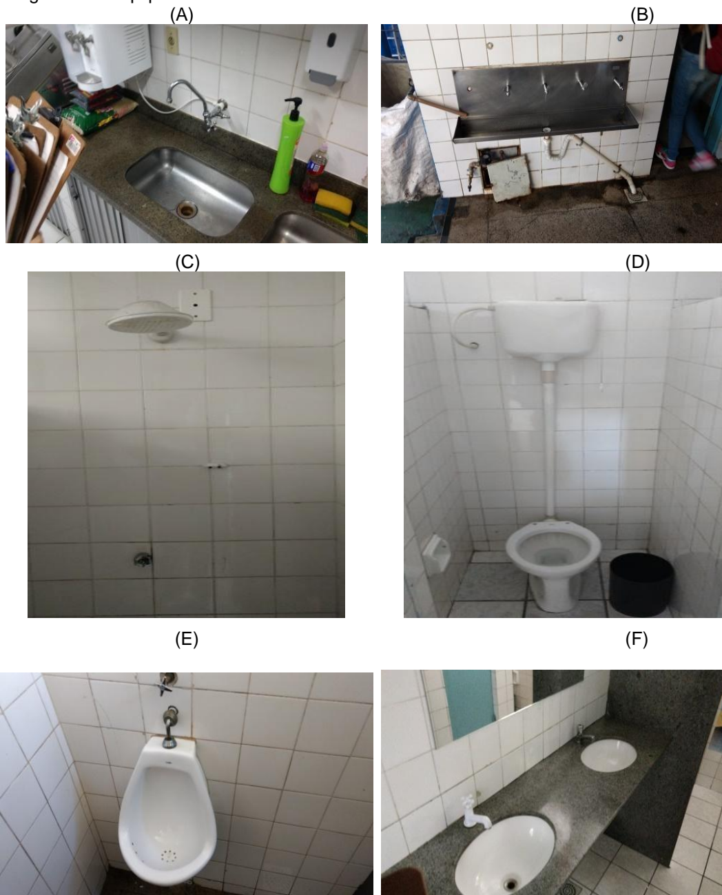
(A) Torneira da cozinha; (B) Bebedouro do primeiro andar; (C) Chuveiro do banheiro masculino do primeiro andar; (D) Bacia sanitária; (E) Mictório masculino e (F) Torneiras dos banheiros Fonte: Autoria própria (2019).
