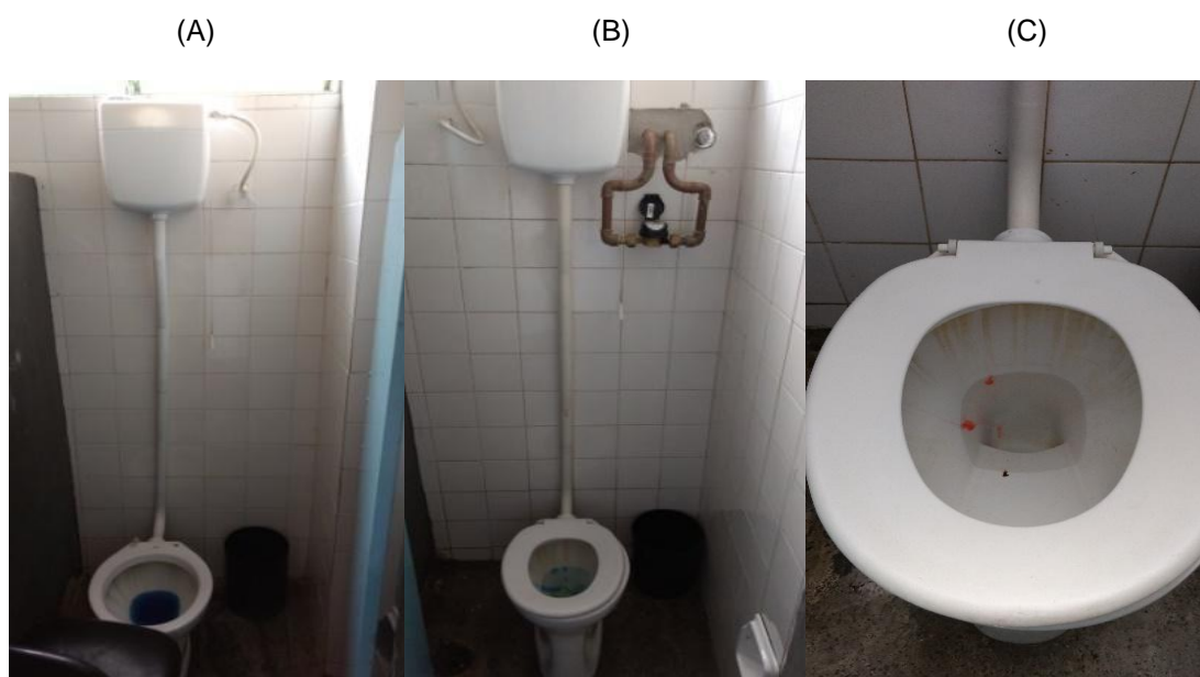
(A) Bacia sanitária do Banheiro feminino do terceiro andar; (B) Bacia sanitária do banheiro masculino do terceiro andar; (C) Detalhe do vazamento da bacia.
