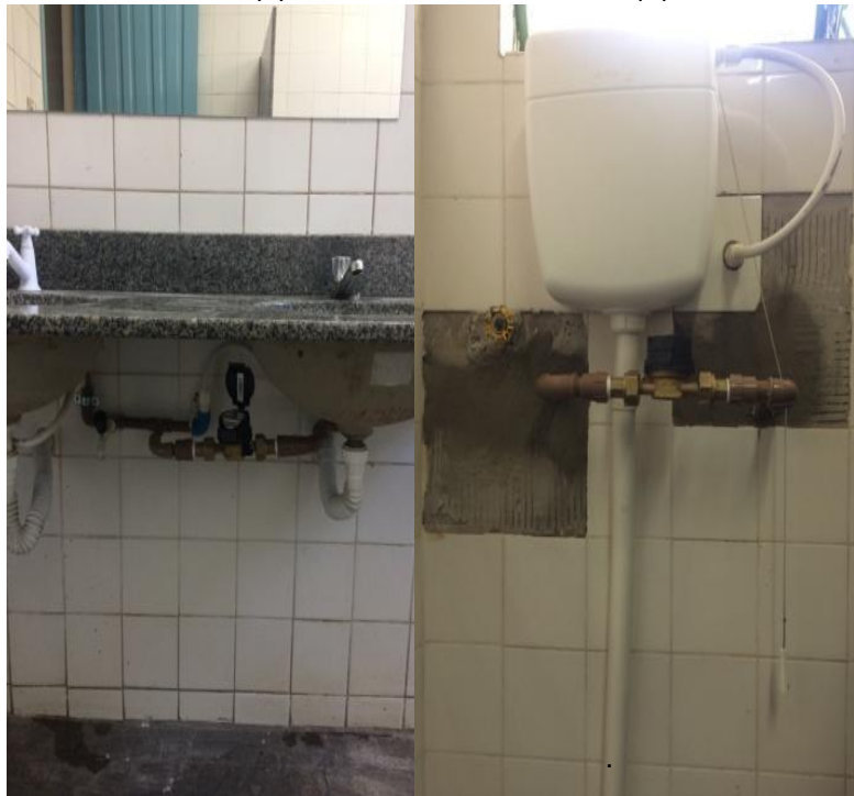
Figura 12 - (a) e (b) – Hidrômetros (H12 e H13) instalados no banheiro feminino – 3º Pavimento (a) (b)
