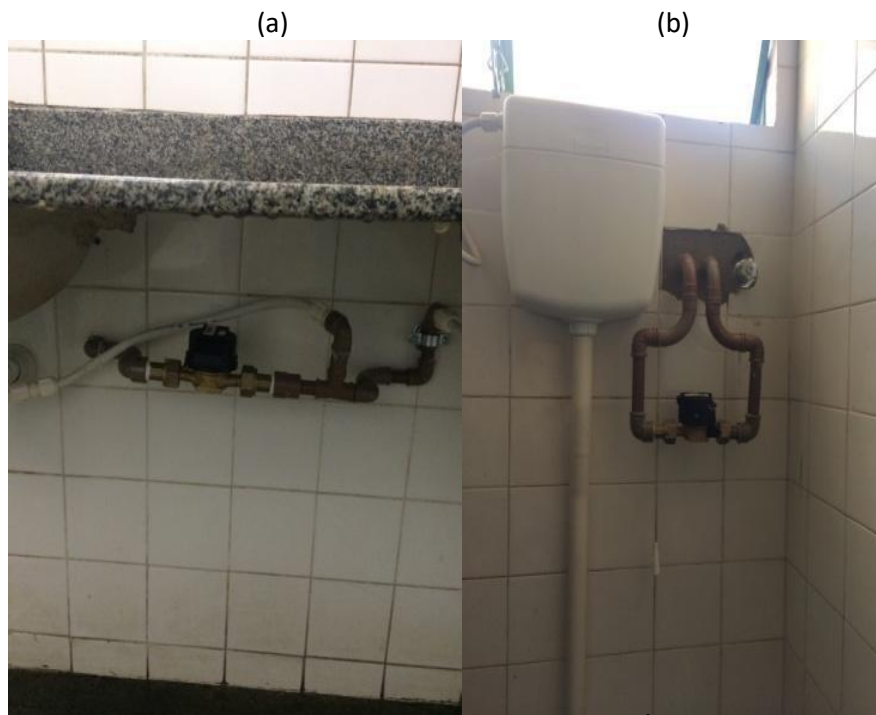
Figura 13 - (a) e (b) – Hidrômetros (H14 e H15) instalados no banheiro masculino – 3º Pavimento
