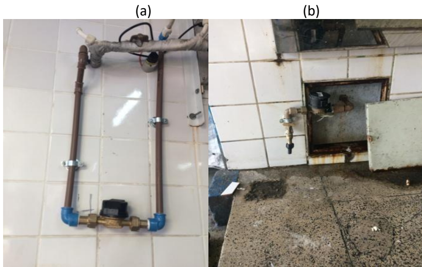
Figura 6 – (a) e (b) Hidrômetros (H3 e H4) instalados no bebedouro e torneira externa - Pavimento térreo
