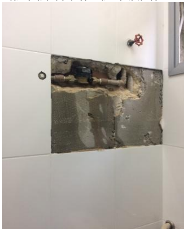
Figura 9 - Hidrômetro (H9) instalado no banheiro/funcionários - Pavimento térreo
