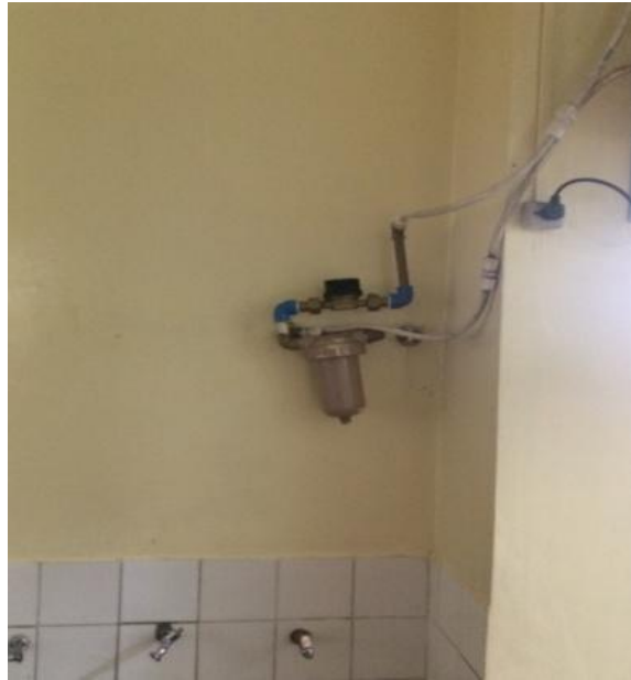
Figura 11 - Hidrômetro (H11) instalado no bebedouro – 3º Pavimento
