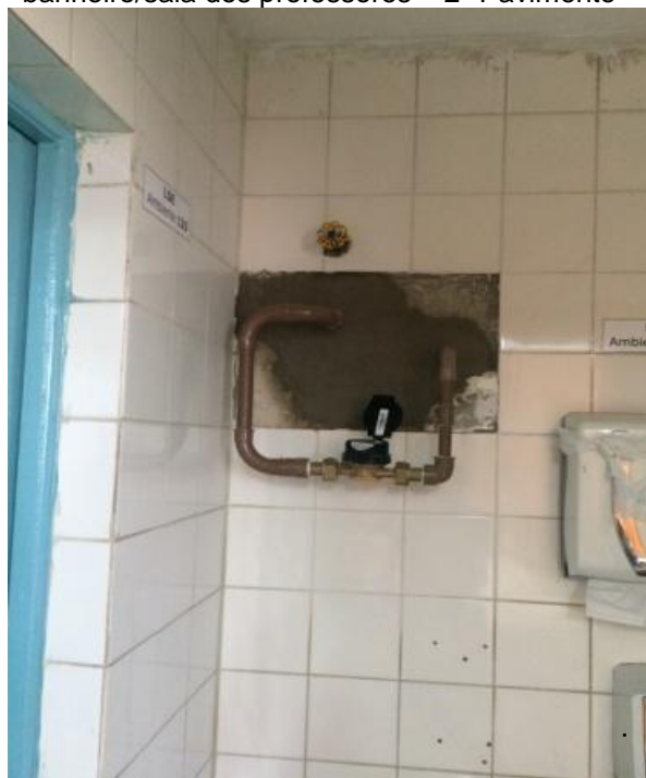
Figura 10 - Hidrômetro (H10) instalado no banheiro/sala dos professores – 2º Pavimento
