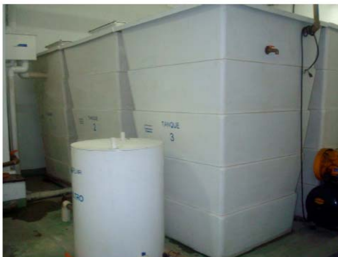
Figura 7 - ETAC instalada na edificação
