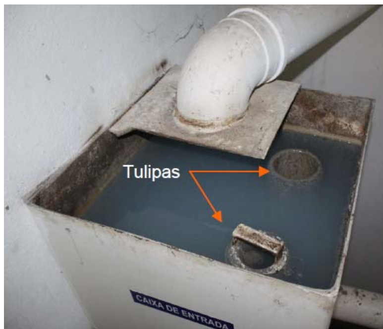
Figura 9 - Tulipas da caixa de entrada da ETAC Fonte: Vaz, 2009, p. 76
